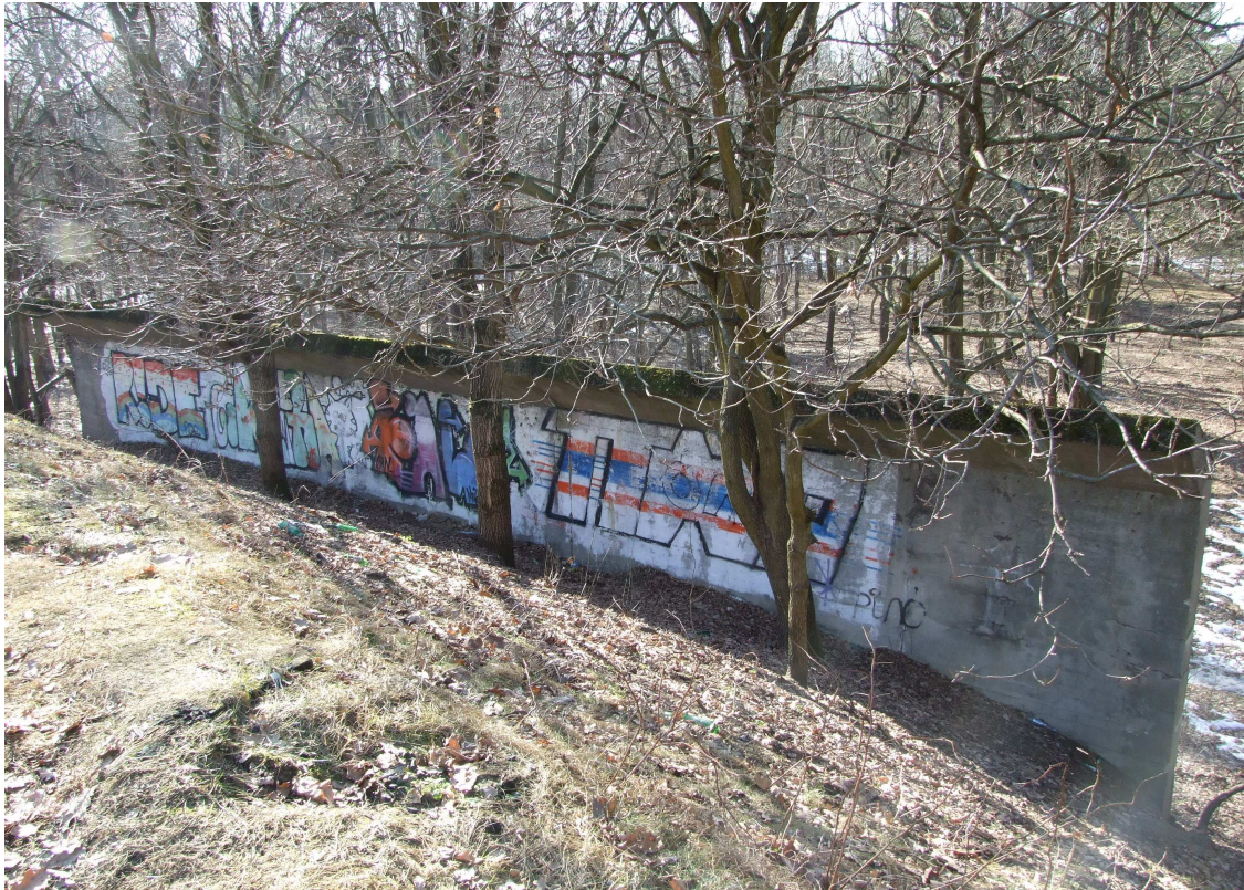
Strzelnica przy Lotnisku Babice, betonowa ściana oporowa za kulochwytem głównym, 2013 r. Fot. Artur Jaroń
